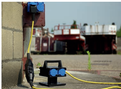
Abb. 13 Schutzverteiler mit vier Steckdosen
