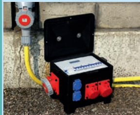
Stromverteiler mit Steckdosen (mobil)
