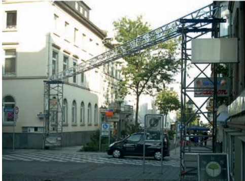
Abb. 1 Hochgelegte Leitung zur Straßenquerung
